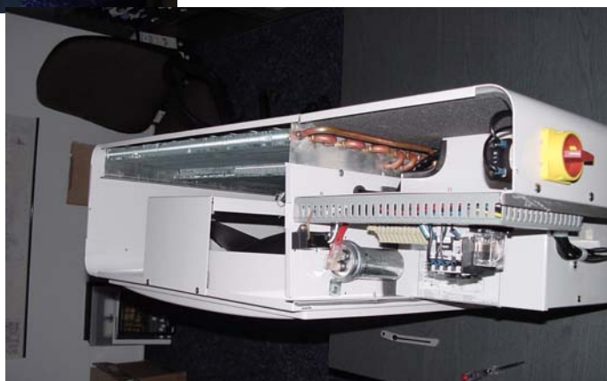
Untere Abbildung: Ansicht von oben in das geöffnete Elektrofach
